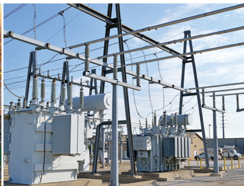
重庆电信 110 千伏变电站
