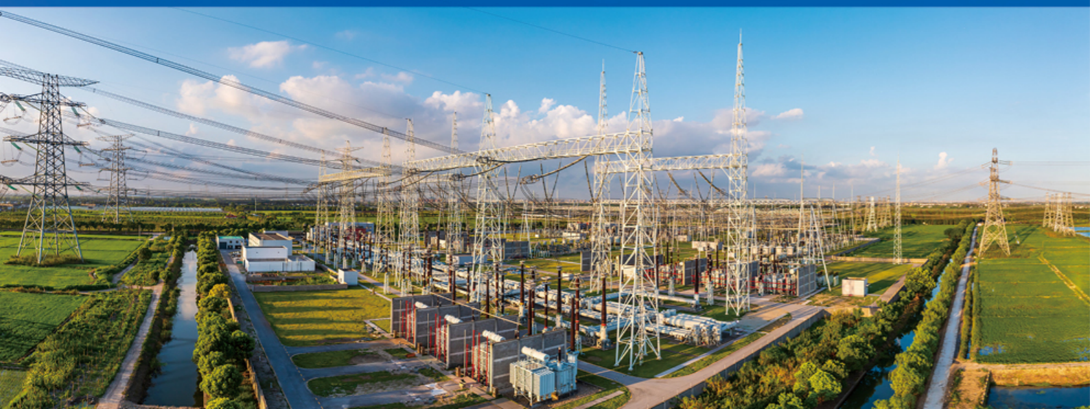
玻利维亚 35 千伏变电站等一带一路能源项目
